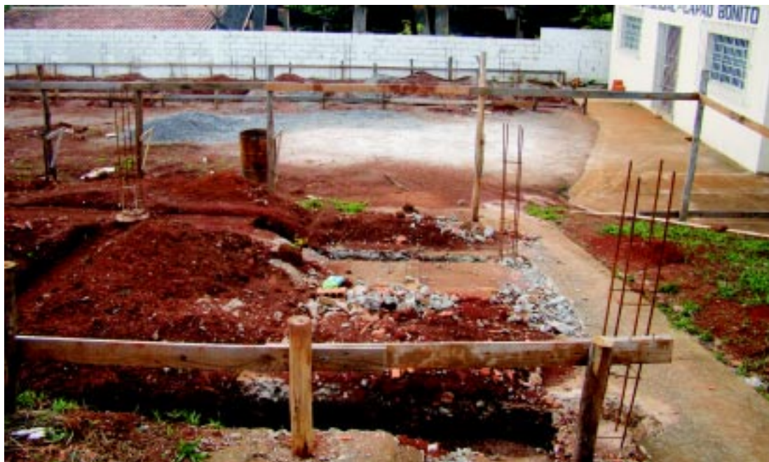
Canteiro de obras da nova Unidade Básica de Saúde da Vila Aparecida
